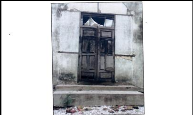
စတင်ဆောက်လုပ်သည့်ခုနှစ် - ၁၉၅၄ ခုနှစ်(နှစ်ထပ်ဆောင်) - အလျား(၁၅၀)ပေ x အနံရံ(၈၀)ပေအမြင့်(၃၀)ပေ - သွပ်မီးအုတ်ညှပ် စာသင်ခန်းအရေအတွက် - အပေါ်ထပ် (အစည်းအဝေးခန်းမ)၊အောက်ထပ်စာသင်ခန်း(၈)ခန်း ကျောင်းဆောင်အမျိုးအစား - အုတ်ညှပ်နှစ်ထပ်ဆောင် တည်နေရာ - ပြည်တော်အစိုးရကွက်၊သရက် - မင်းတုန်းလမ်း၊မြောက်ဘက်
